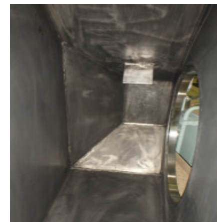
【 EGR gas piping 】
